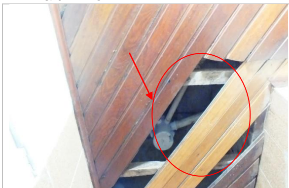
Figura 14: Forro deteriorado e instalação exposta.
