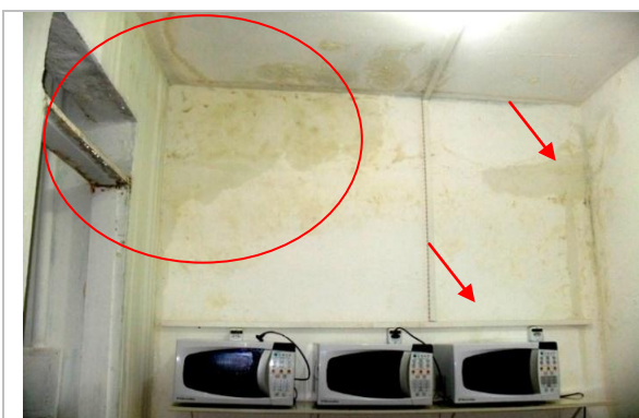
Figura 44: Infiltração da laje, perigo de curto circuito.
