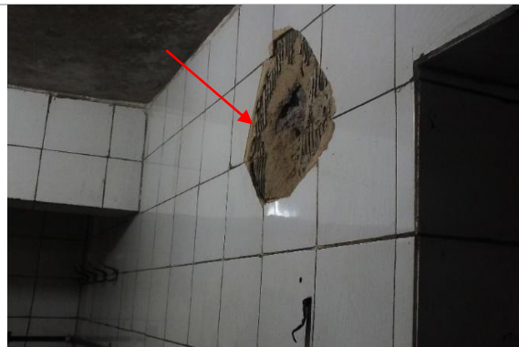
Figura 23: Delaminação do revestimento.
