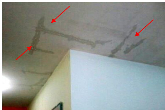
Figura 42: Infiltração no teto dos quartos.
