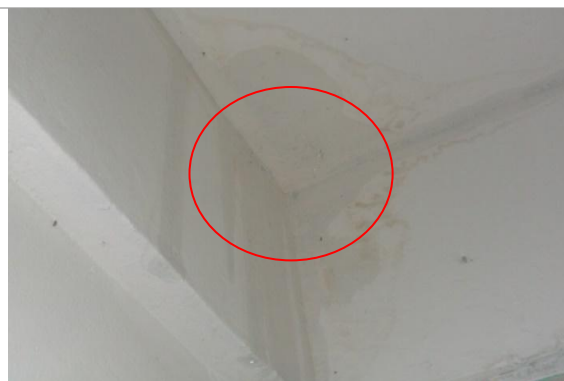
Figura 41: Infiltração pelas juntas dos elementos.
