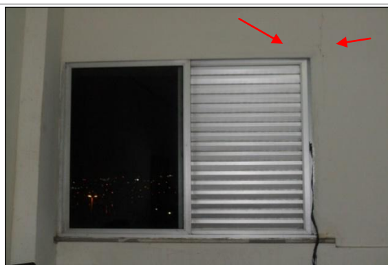
Figura 29: Fissuras na parte superior da janela.
