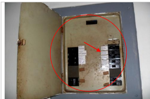
Figura 32: Quadros de força fora das normas.
