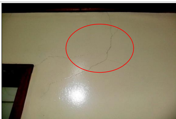
Figura 28: Trincas e fissuras na parte superior da porta.
