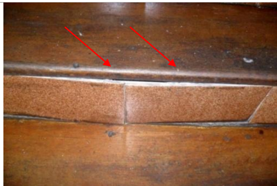
Figura 22: Desplacamento da cerâmica.
