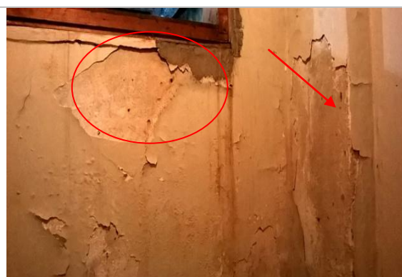
Figura 21: Desprendimento do revestimento e pintura.
