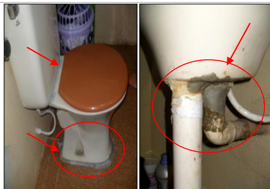
Figura 36: Louças com infiltrações.
