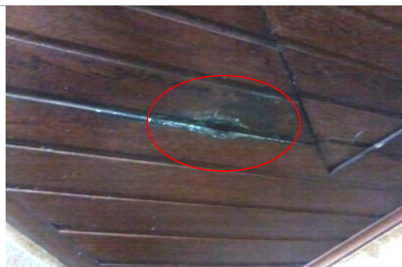
Figura 15: Forro com infiltração.
