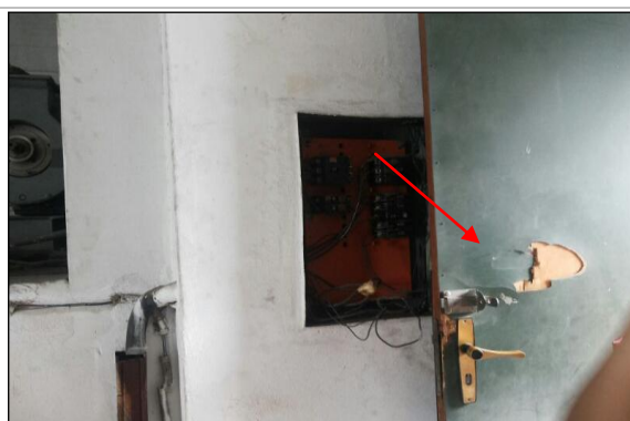
Figura 27: Esquadria deteriorada e quadro de força exposto.
