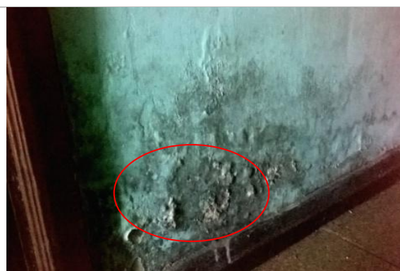
Figura 19: Desprendimento do substrato.
