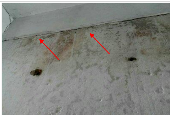
Figura 12: Trinca e descolamento da parede.
