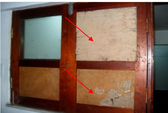
Figura 26: Janela com adaptação inadequada.
