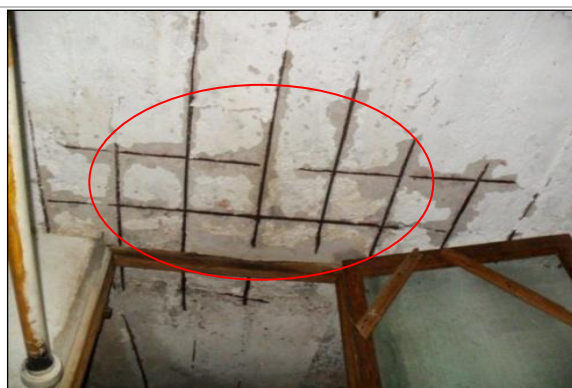
Figura 8: Armadura exposta e com corrosão.
