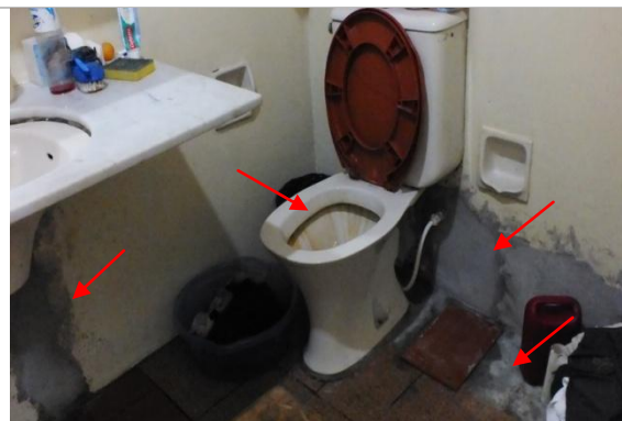
Figura 35: Instalação fatigada e falta de reboco.
