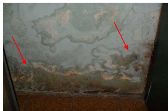
Figura 18: Manchas na pintura.
