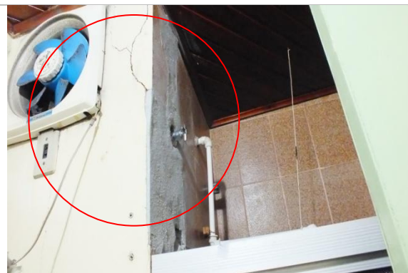
Figura 34: Instalação precária na tubulação.
