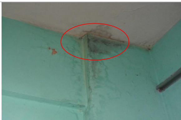
Figura 10: Manchas de umidade e mofo causando degradação do substrato.
