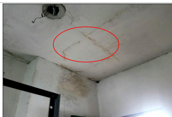
Figura 6: Fissura no teto e falta de manutenção da instalação elétrica.
