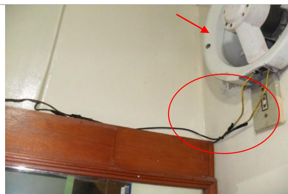
Figura 30: Cabeamento exposto e exaustor danificado.
