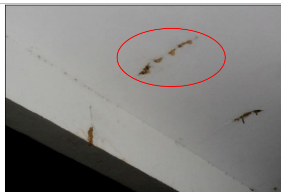
Figura 9 : Carbonatação da armadura.
