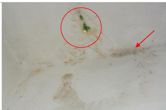
Figura 40: Infiltração, manchas e bolor.
