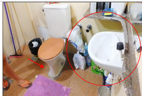
Figura 37: Instalação e louça desgastada.
