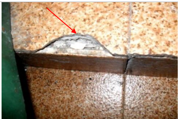
Figura 24: Quebras da cerâmica.
