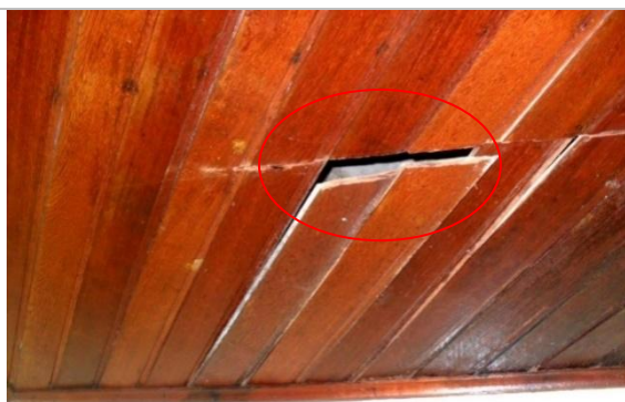
Figura 16: Deslocamento da madeira do forro.
