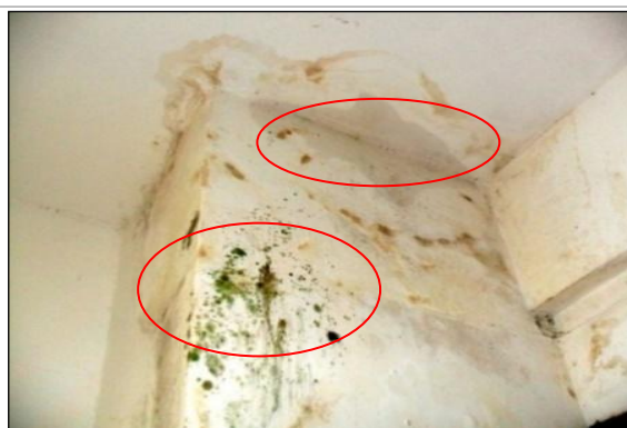
Figura 11: Manchas escuras e bolor devido as infiltrações.
