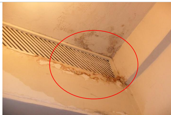
Figura 43: Infiltração na tubulação do banheiro.
