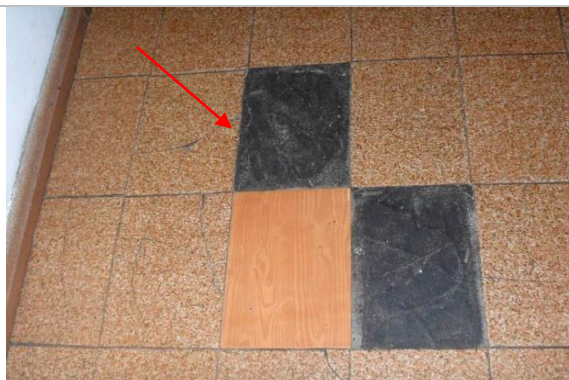
Figura 25: Descolamento da cerâmica.
