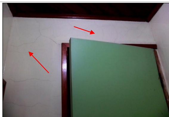
Figura 13: Fissuras e trincas.
