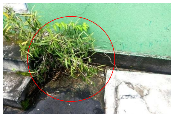
Figura 45: Infiltração da laje e presença de plantas.
