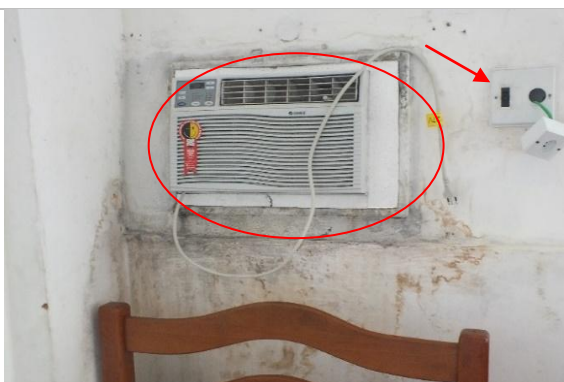
Figura 31: Infiltração pela abertura da caixa do ar condicionado e instalação inadequada.
